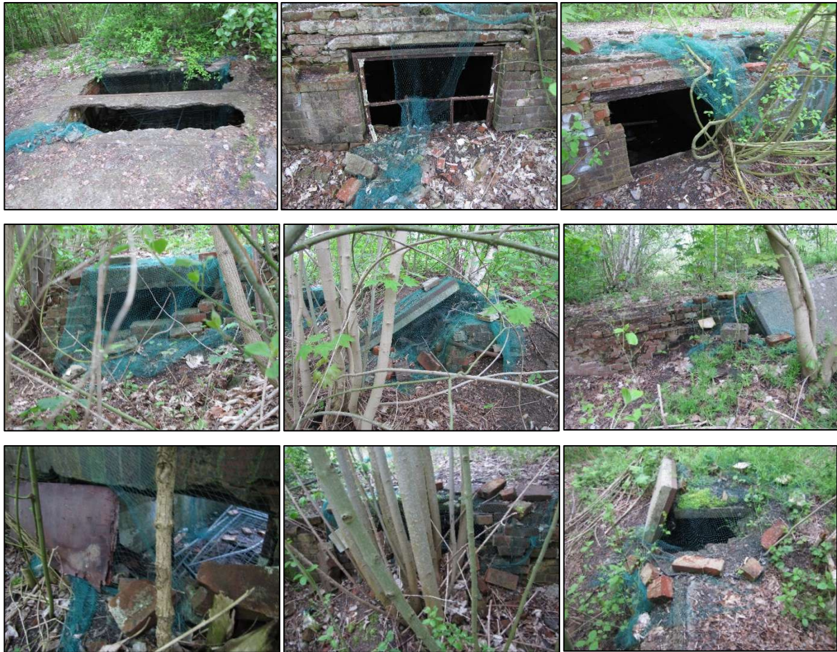
Abb. 10: Mit Netzen abgedeckte Fensteröffnungen in die Kellerräume, teils entfernt (obere Reihe)
