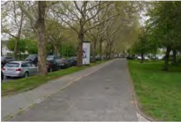
Abbildung 77: Der Radweg entlang der Pestalozzistraße weist Belagsschäden auf
