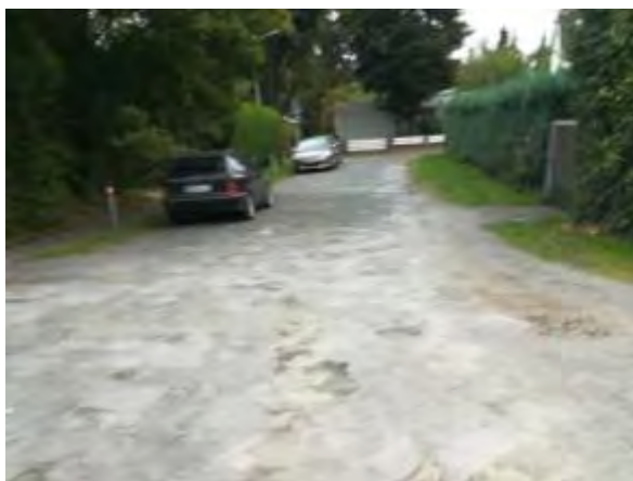
Abbildung 71: Starke Belagsschäden in der Apenrader Straße (Bahnhof Lehe)
