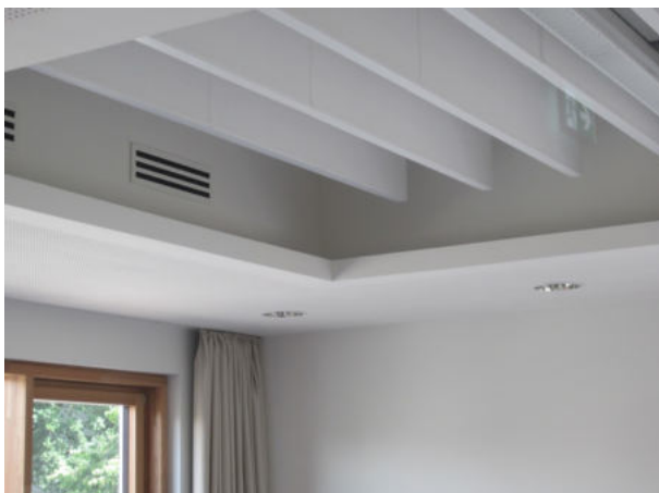
Deckendetail, Lüftung, Akustikelemente
