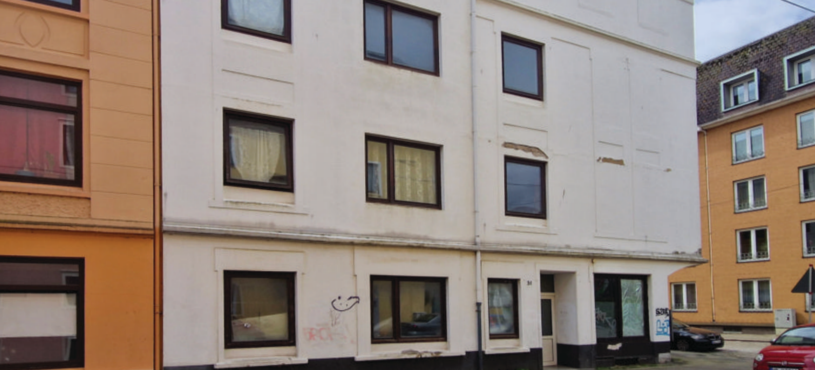
Sanierungsbedürftiges und teilweise leerstehendes Eckgebäude Eupener Str. 31
